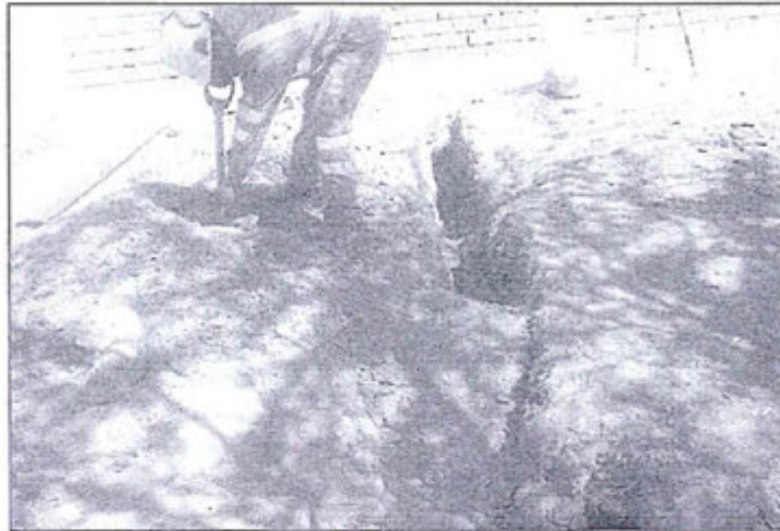
Foto N° 03: Ejecución de trabajos en cierre de zanjas depunto de vertimiento del punto de vertimiento N° 1.
