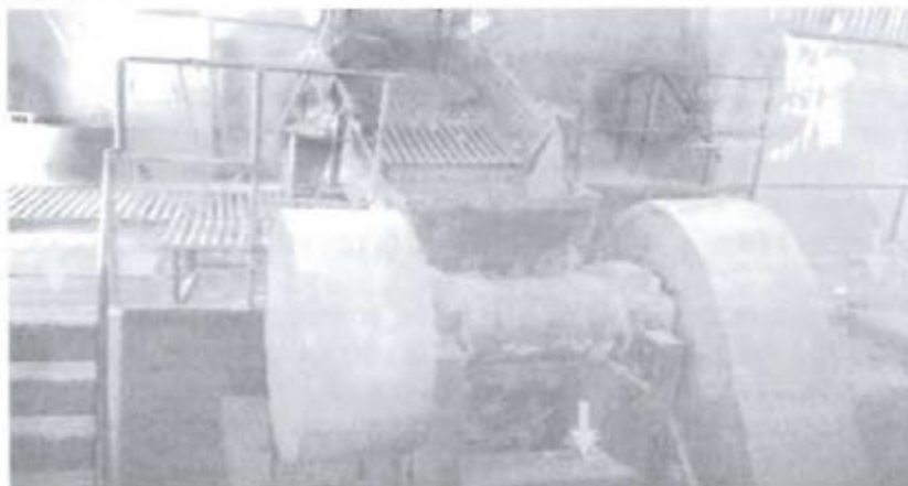
Foto 13: Tolva de descarga a la chancadora primaria, donde se observa acumulación de polvo.
