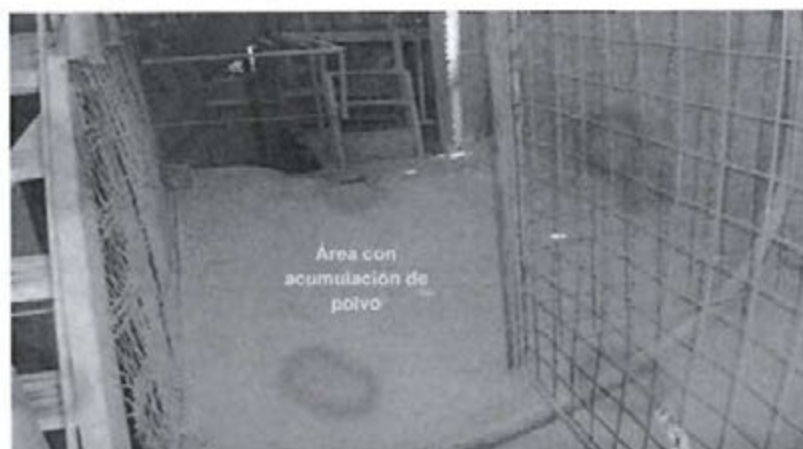
Foto 14: Falta de un sistema de control y mitigación de polvo, genera la presencia de material particulado en el acceso a las áreas de chancado primario y secundario.
