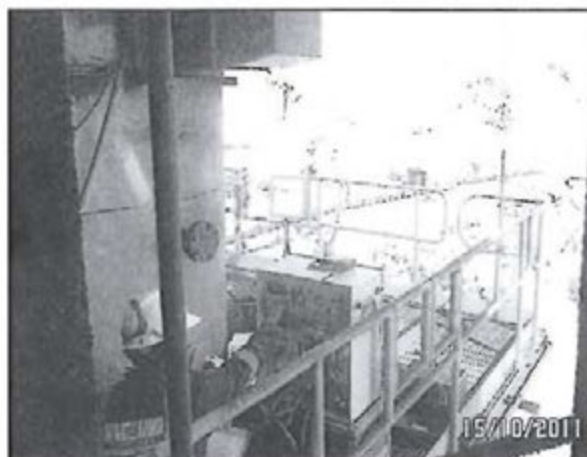
Fotografía N° 101: Instalación de equipos de medición en el punto de monitoreo Chimenea Edificio Horno ISA-EISA.
