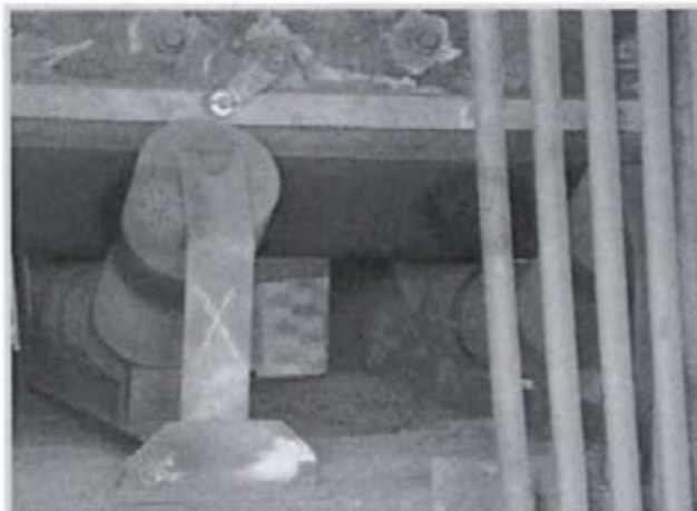
Fotografía N° 3: Presencia de material de lecho de fusión en el sistema de descarga de concentrados hacia la faja 220, el material genera dispersión de partículas en el aire (Coordenadas UTM: 0249720E; 8063748N).
