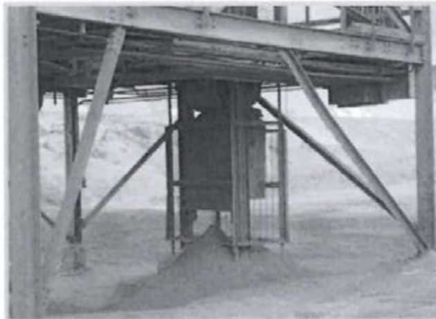
Fotografía N° 2: Presencia de concentrado de cobre en el piso, originado por el retomo de la faja de alimentación al lecho de fusión.
