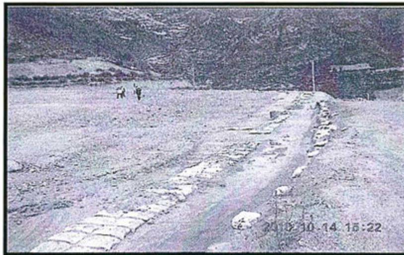
Fotografía N° 55.- Recomendaciones 2010 N° 14 Plataforma del depósito de relaves Amanda I sin perfilado ni medidas de control de erosiones
