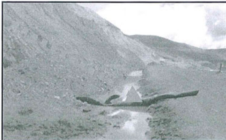
Fotografía N° 28: Acumulación de material por falta de mantenimiento el canal de coronación de la Presa de Relaves N° 6 de la Planta Concentradora Mahr Túnel ubicada en las coordenadas UTM WGS 84: 0386223E, 8714940N, 4041 msnm.
