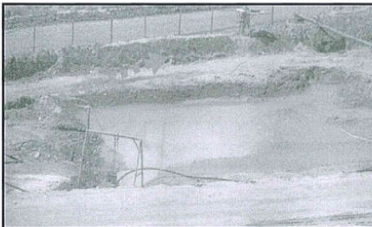
Fotografía N° 30: Acumulación de material por falta de mantenimiento el canal de esorrentía de la Presa de Relaves N° 6 de la Planta Concentradora Mahr Túnel ubicada en las coordenadas UTM WGS 84: 0386518E, 8714812N, 4013 msnm.
