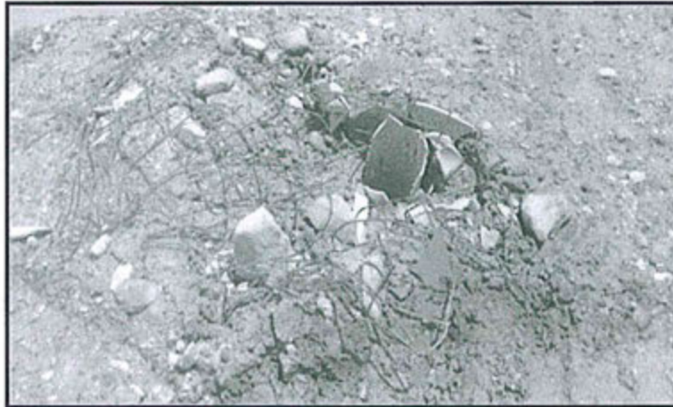
Fotografía N° 36: Chimeneas del sistema de relleno sanitario de Toldorrumi – San Cristóbal destruidas por falta de identificación coordenadas UTM WGS 84: 0385435E, 870145N y 4764 msnm.
