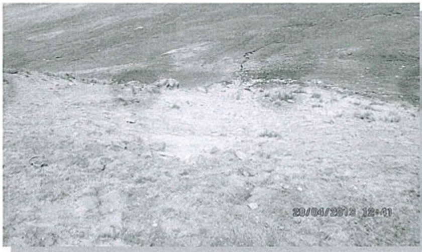
Foto 03: Hallazgo N° 1: En la poza de sedimentación de la plataforma MAR12-05, con coordenadas UTM: 8 386 103N y 404 126E, se observa la falta de nivelación y revegetación.
