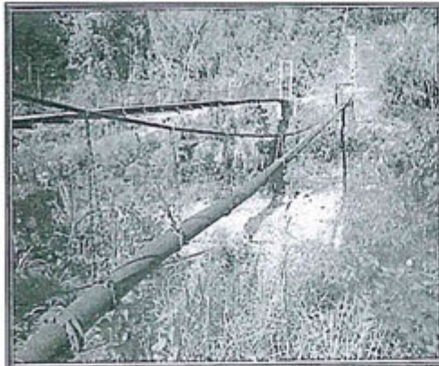
FOTOGRAFIA N° 13.- Observación N° 6: Tubería HDPE de 12" de diámetro que transporta los relaves de la Planta Concentradora hacia el depósito La Esperanza, que se encuentra suspendida mediante cable de acero sobre el río Puntayacu (aprox. 50 m), no cuenta con medidas de contingencia.
