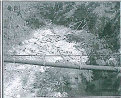
FOTOGRAFIA N° 14.- Observación N° 5: Otra vista de la tubería HDPE de 12" de diámetro que transporta los relaves de la Planta hacia el depósito La Esperanza, que se encuentra suspendida mediante cable de acero sobre el río Puntayacu (aprox. 50 m), no cuenta con medidas de contingencia.
