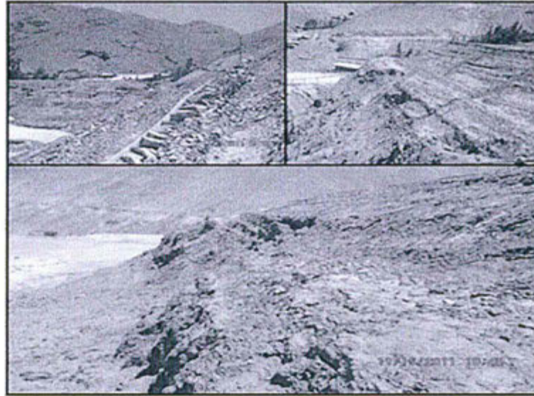
Fotografía N° 11.- (Obs. N° 9): Talud del depósito de relaves de cianuración N° 1, 2, 3 y 4; Talud se encuentra erosionado.
