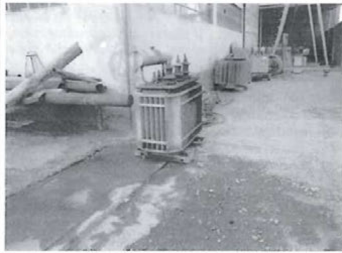
Vista 4. Loza del taller con malas condiciones del suelo, no apto para almacenar equipos conteniendo sustancias peligrosas.
