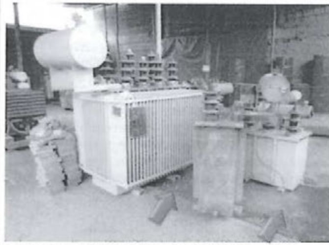
Vista 3. Vista de las características del suelo permeable, sin la debida protección para almacenar transformadores conteniendo sustancias peligrosas.
