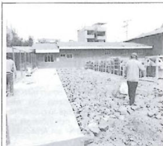
En esta otra vista se aprecia la ampliación de la losa impermeabilizada en el almacén central donde se trasladarán los transformadores nuevos y de segundo uso observados.
