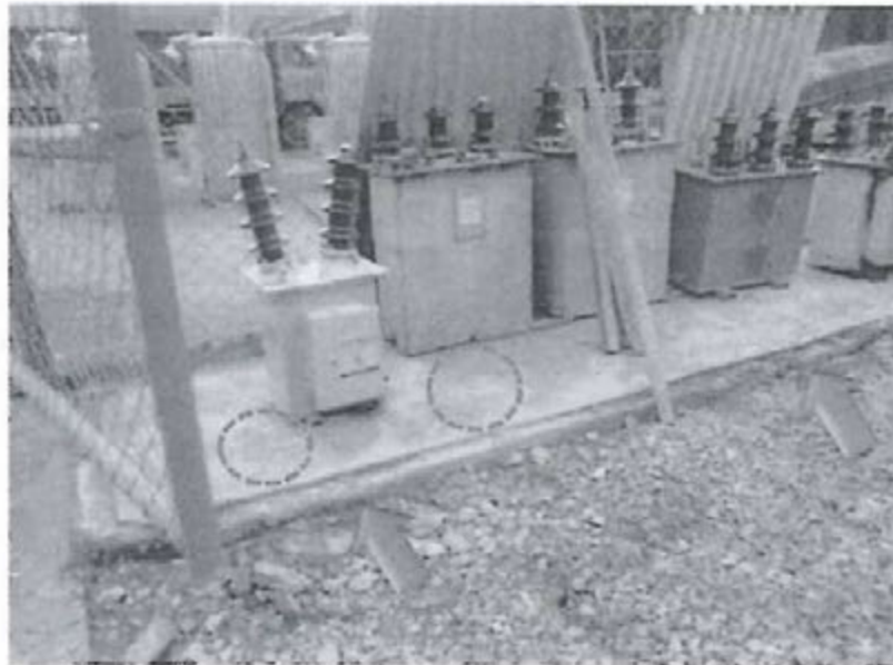
Vista 1. El muro de contención ha desaparecido (ver flechas), y el suelo está fisurado en varios lugares (ver fisuras).
