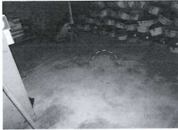
Vista 5. Vista parcial de las condiciones del piso del almacén, donde se observa que el piso no está impermeabilizado en toda su extensión, sino que está dañado en diversas partes.
