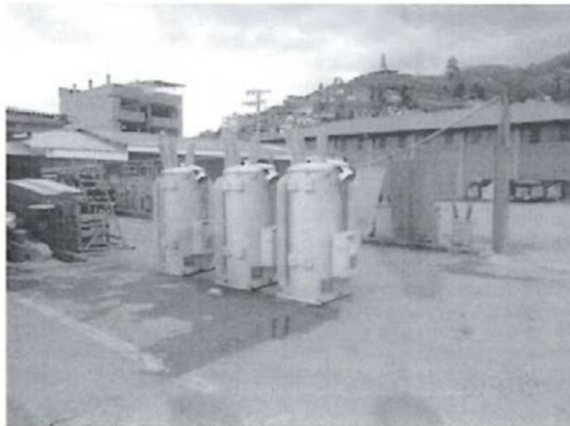
Vista 2. Se observa solo un grupo de transformadores, de los muchos que estaban en el almacén. Los pisos no están preparados para recibir materiales peligrosos, pues no estaban lisos, ni impermeabilizados, ni tenían muro de contención.
