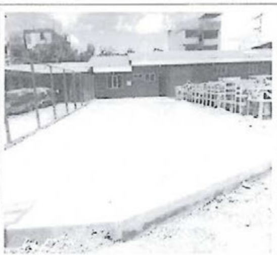
Losa ampliada y terminada del almacén central pintada con esmalte epóxico lista para albergar los transformadores nuevos y de segundo uso observados
