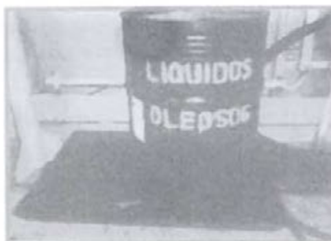
Foto 12: Cilindros de residuos líquidos oleosos con rótulo de identificación colocados sobre la bandeja de contención en la Plataforma Albacora.
