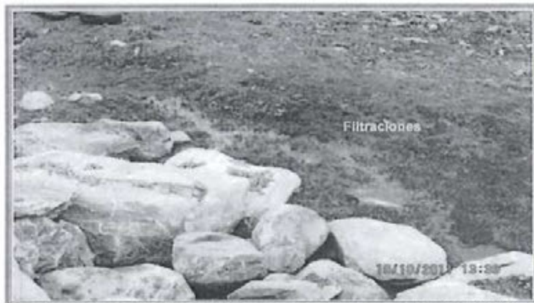
Fotografía N° 13 del Informe de Supervisión: Vista fotográfica en el que se observa que detrás de las pozas de sedimentación N° 1 y 2 de bocaminas Nazca-Paracas y a una distancia aproximada de 3 m. del punto de control E-04, existen filtraciones sobre suelo natural.
