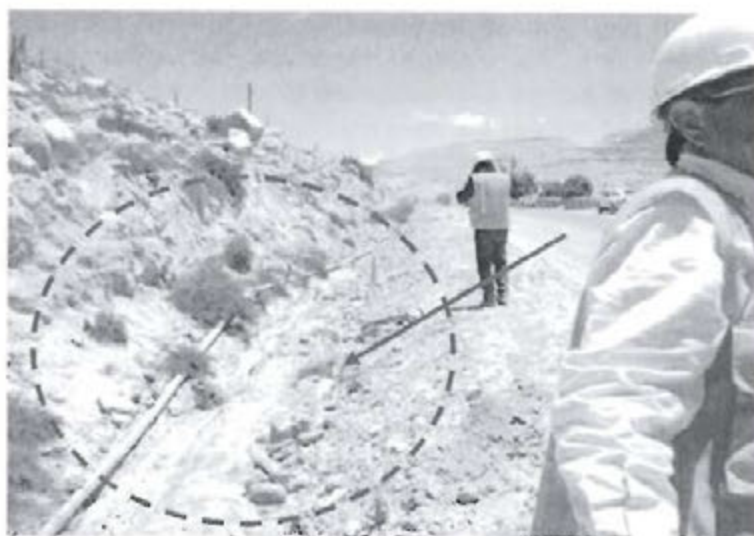
Fotografía N° 1: En el tramo construido del canal de drenaje de lluvias ubicado en la zona Sur Oeste del tajo abierto, existe un tramo con apariencia de haber sido impactada con hidrocarburos. Además, este canal de derivación de lluvias está sin mantenimiento.
