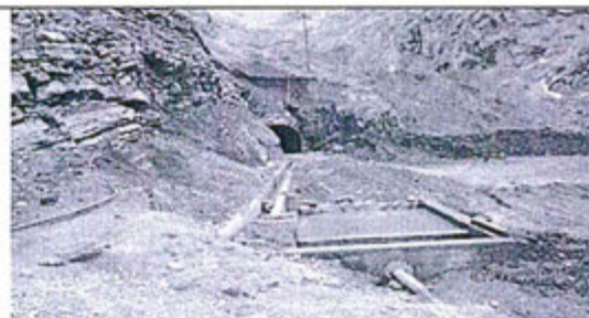
FOTO N°5: Observación N°2-2011: Las aguas de la Bocamina del nivel 4940, dentro de la primera poza de sedimentación, permanecen turbias por falta de mantenimiento de ésta.
