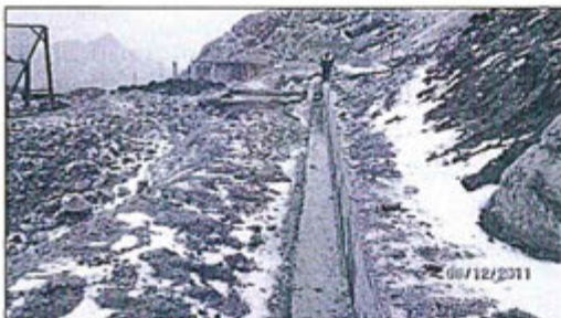
FOTO N°4: Observación N°2-2011: Las aguas provenientes de la bocamina del nivel 4940 son transportadas por un canal de concreto hacia la primera poza de sedimentación
