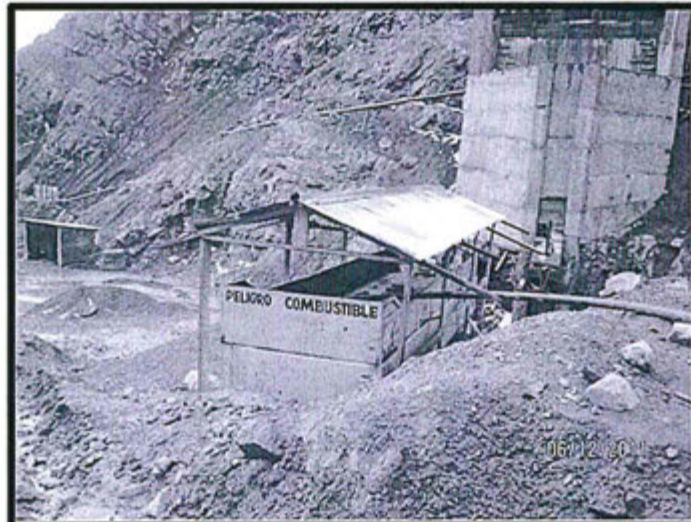
FOTO N° 12: Observación N°5-2011: Depósito de combustible (petróleo) con techo de dos aguas, sin poza de contención ante eventual derrame de combustible
