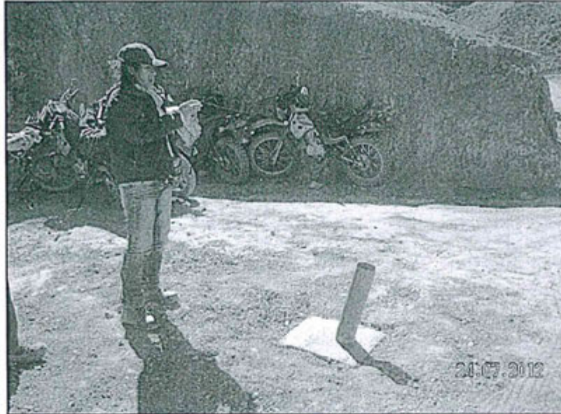
Foto N° 11.- Dado de concreto indicando la fecha de obturación y cierre del taladro PE-02. La Supervisión lo ubicó en la zona 17L. E: 784712 / N: 9075224
