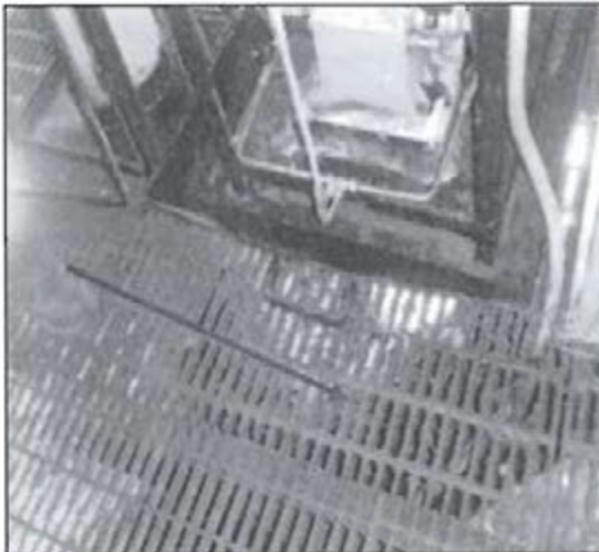
Fotografía N° 22 del Informe de Supervisión: Plataforma CX-11, vista de parrilla manchada con hidrocarburos.
