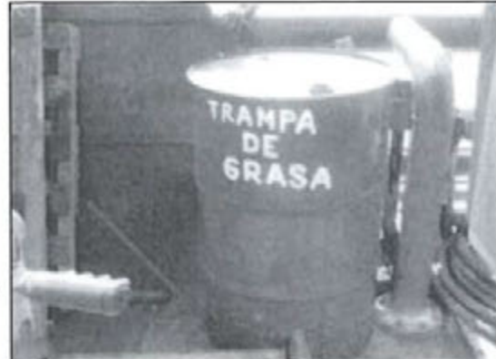
Fotografía N° 12 del Informe de Supervisión: Vista del almacenamiento de lubricantes y químicos en la Barcaza BPZ-01. Obsérvese que el área no es adecuada y no cuenta con doble sistema de contención de derrames.
