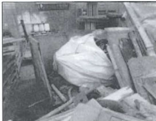
Fotografía N° 15 del Informe de Supervisión: Muelle La Cruz, vista de almacenamiento de residuos en un área inadecuada, a granel, sin su correspondiente contenedor.
