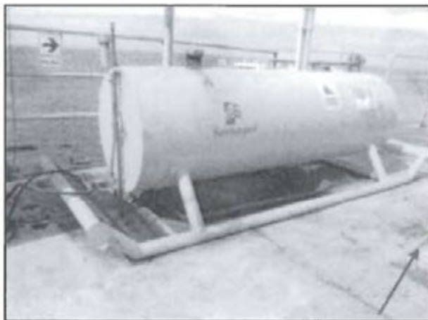
Fotografía N° 10 del Informe de Supervisión: Vista del almacenamiento de combustibles en la Plataforma A-8. Obsérvese que el tanque no cuenta con sistema de contención de derrame alrededor del tanque.
