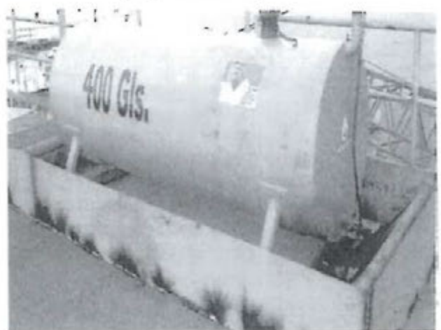
Fotografía N° 5 de la Carta BPZ-EN-GG-426-2012: Tanque de almacenamiento de diesel con sistema de contención de derrame en la Plataforma Albacora.
