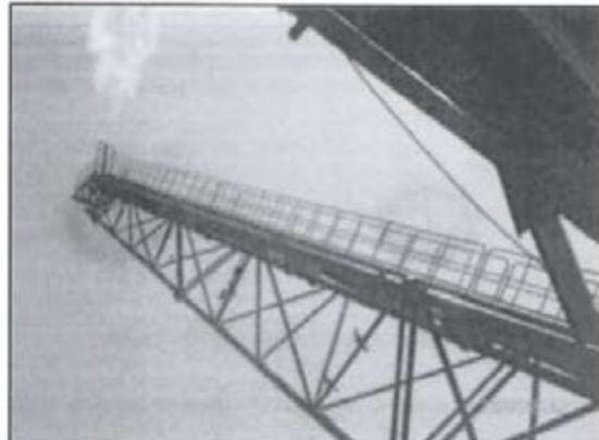
Fotografía N° 27 del Informe de Supervisión: Vista del Flare de la Plataforma CX-11. Fotografía tomada a la altura en donde se evidenció película visible de hidrocarburos en aguas de mar.
