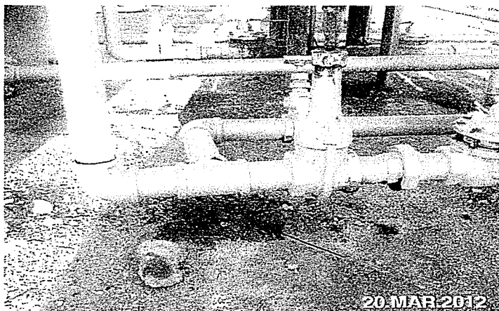
Fotografía N° 11: En Bateria Carrizo 22, se observó suelo impregnado con hidrocarburos (aprox. 0.25 m 2 ).
