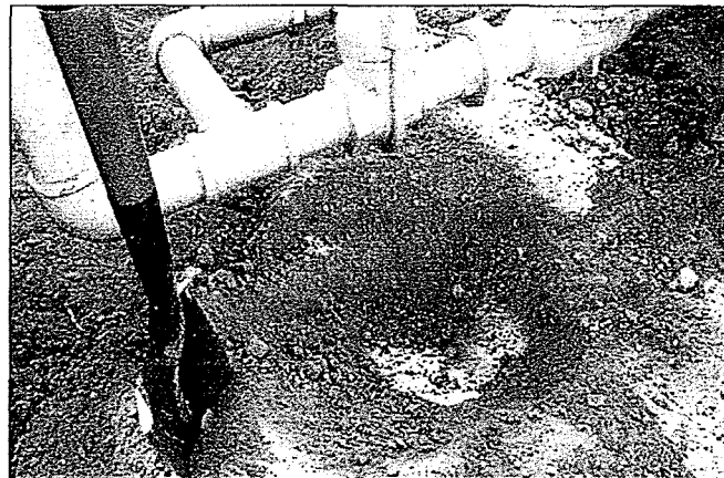
Fotografía N° 8: Se procedió al saneamiento del área afectada dentro de la Batería CA22
