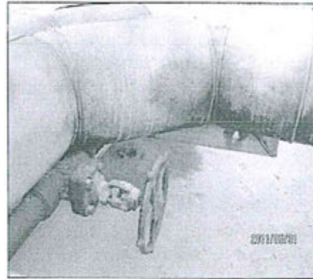
Fotografía N° 5: Fuga de las tuberías que se encuentran próximas al tanque de almacenamiento de asfaltos N° 36, ocasionado posiblemente por la falta de mantenimiento de las líneas, bridas, etc.
