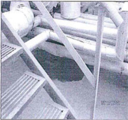
Fotografía N° 6: Se observó un área aproximada de 0.5 m 2 de suelos impregnados con hidrocarburos, producto de la fuga de las tuberías que se encuentran próximas al tanque de almacenamiento de asfaltos N° 36.
