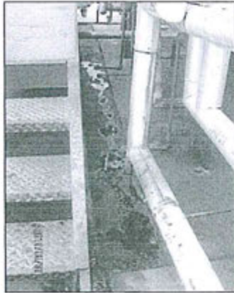
Fotografía N° 2: Se detectó un área aproximada de 1.5 m 2 de suelos impregnados con hidrocarburos, en la zona inferior del manifold de las líneas de producción de la Planta
