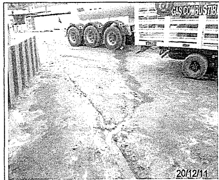
Fotografía N° 5: Se observa filtraciones de líquidos dentro de las instalaciones.
