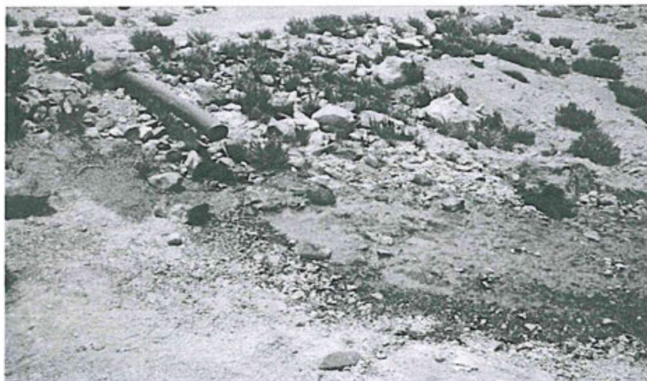
"Fotografía N° 28: Tubo que conduce el sub drenaje de la relavera N° 6 al terreno natural".
