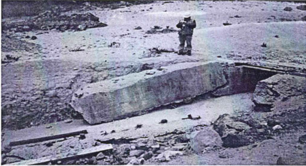
"Fotografía N° 26: Canal de coronación de la relavera N° 6, obsérvese que no se ha concluido su construcción y se encuentra en proceso de deterioro, U.P. Arcata. Recomendación N° 4".
