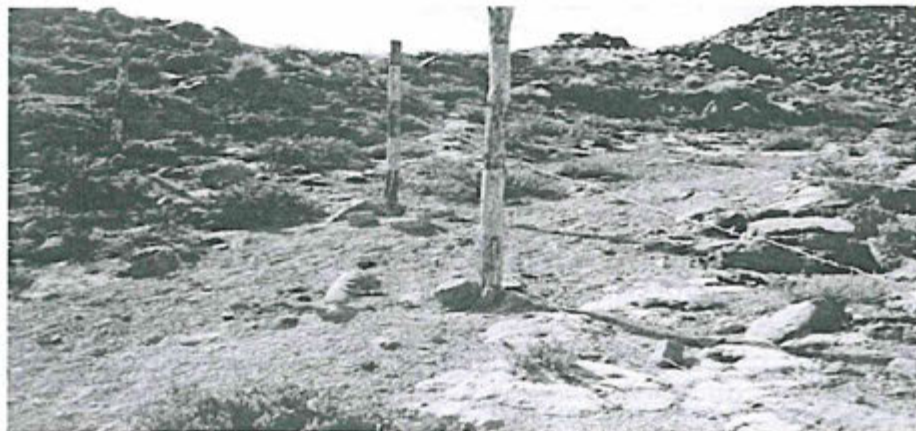
"Fotografía N° 77: Cerco del botadero controlado, no presente ninguna seguridad".
