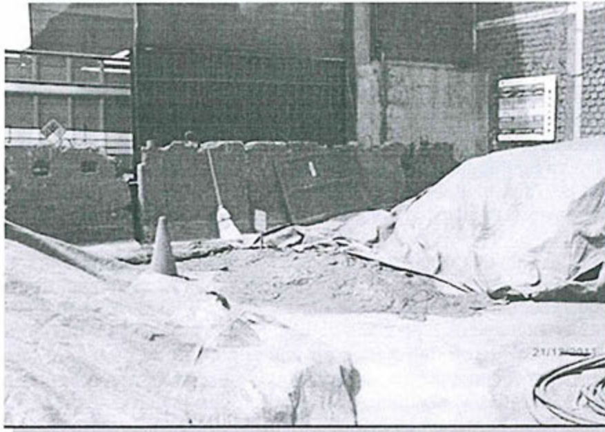
Foto 04: Observación 02, área de secado de los lodos provenientes de las pozas de sedimentación, no están diseñadas de acuerdo al plan de manejo ambiental.
