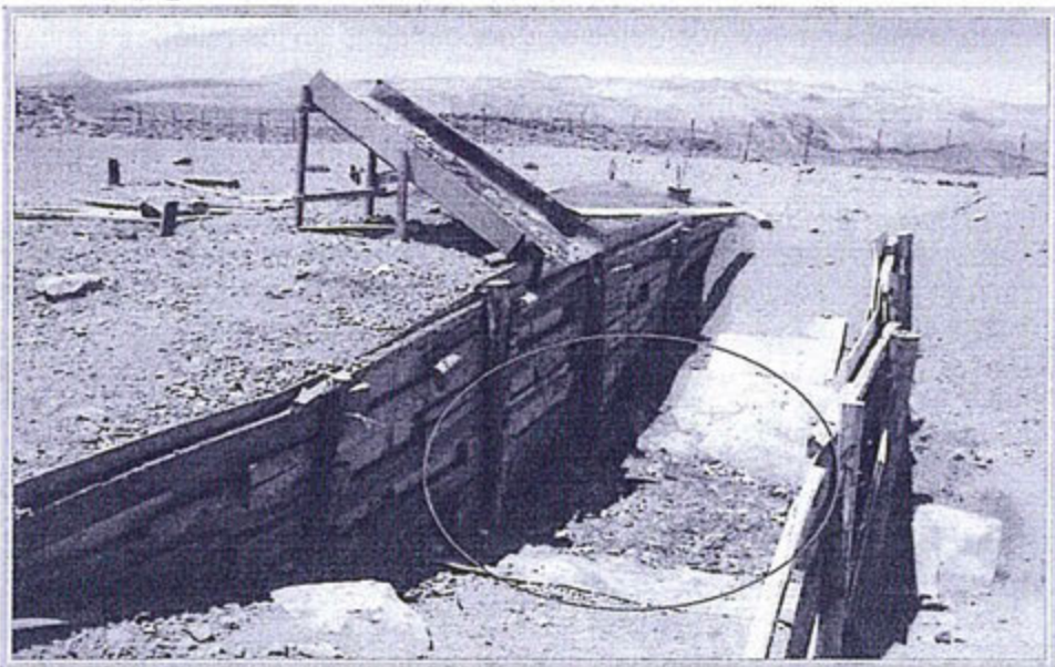
"Fotografía N° 75: Disposición de los residuos sólidos domésticos en la celda de confinamiento de relleno sanitario, los cuales se encuentran expuestos a la intemperie, la celda esta revestida con geomembrana (...)"
