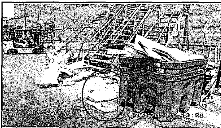
Foto N° 42: Almacenamiento de cartones fuera de almacenamiento de residuos sólidos no peligrosos y otros residuos sólidos dispuestos al costado de éste.
