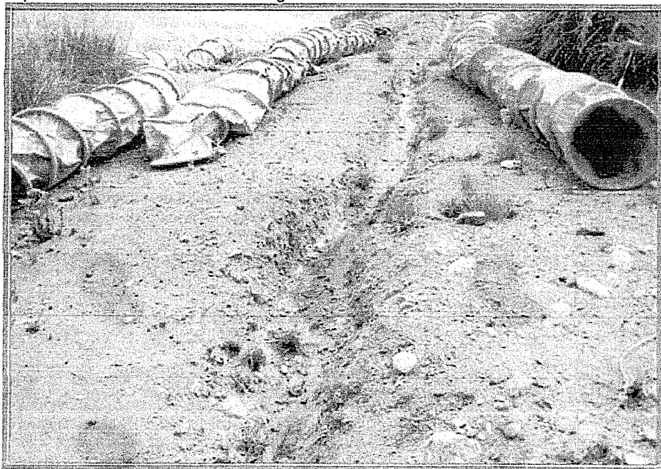
Fotografía N° 35.- Canal de descarga de aguas residuales del comedor sin revestimiento y dirigido hacia el canal de captación de aguas de lluvia.
