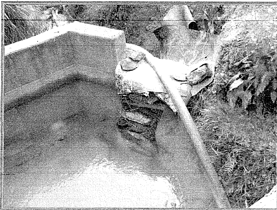
Fotografía N° 37.- Abertura para descargas de aguas ácidas directamente a la quebrada, se observa que el taponeo artesanal existente, no garantiza que no haya escape de agua ácida.
