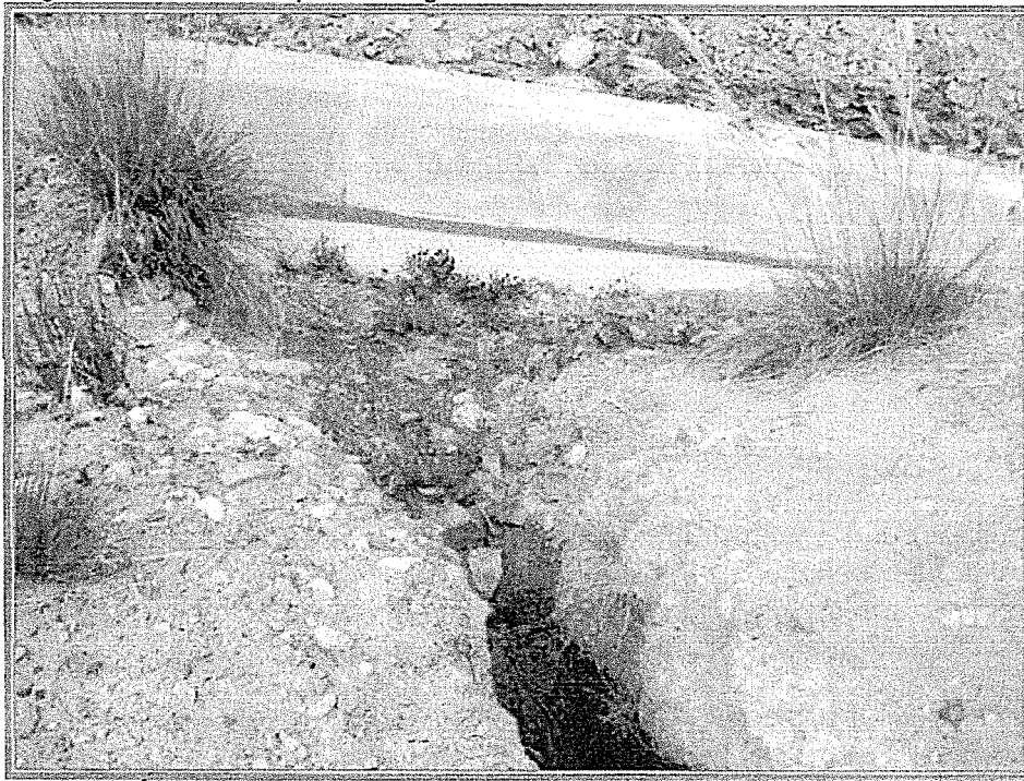
Fotografía N° 36.- Punto de ingreso del canal de aguas residuales domésticas al canal principal de captación de aguas de lluvia.
