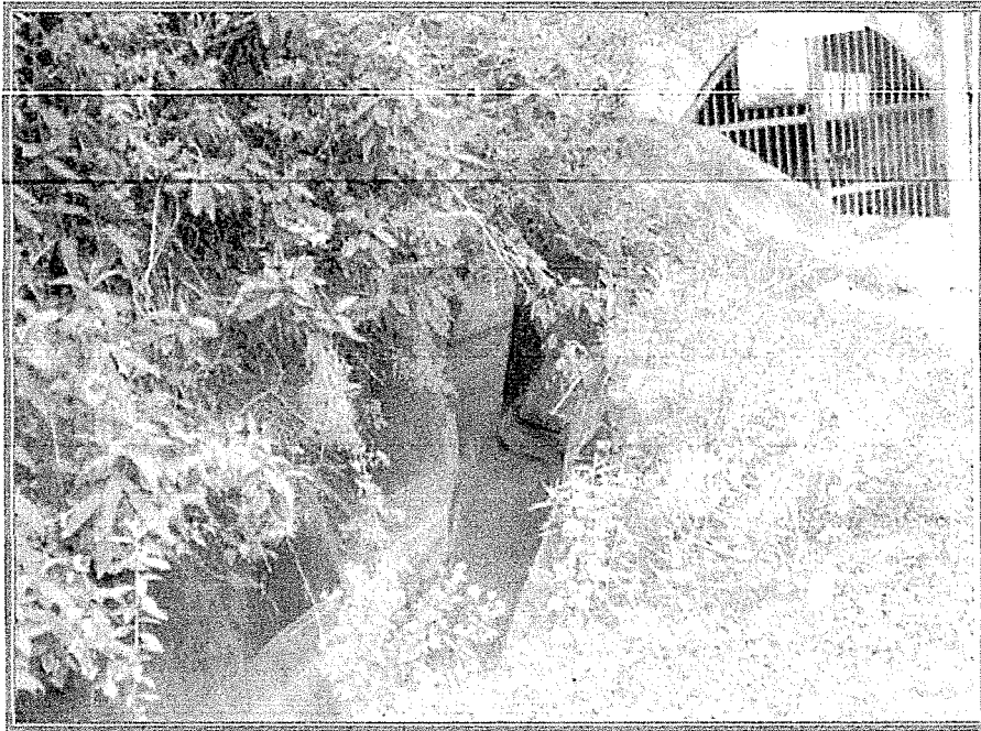
Fotografía N° 15.- Canal de salida de agua del túnel Pucará, se encuentra revestido con geomembrana para evitar filtraciones y afectación del entorno.
