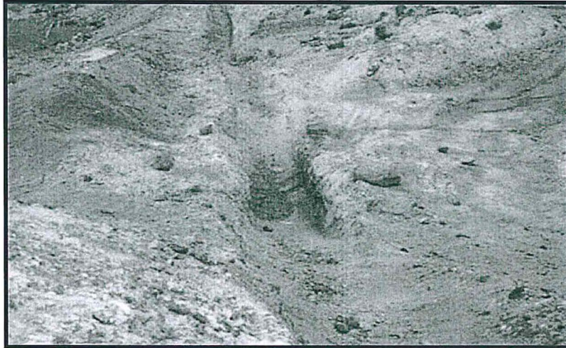
Foto N 11: Canal de coronación de la desmontera San Narciso, obsérvese la falta de construcción en un tramo aproximado de 60 metros, entre las coordenadas N 8 782 016, E 344 195 y 4 636 m.s.n.m
