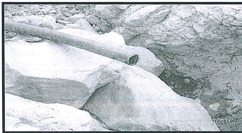
Fotografía N° 10: Vista fotográfica de la tubería de descarga a una distancia aproximadamente de 5 metros debajo de la poza de sedimentación de aguas de mina.
