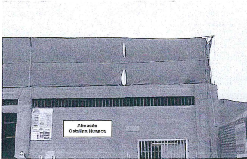
Fotografía N° 25. Malla con rajaduras sobre el almacén Catalina Huanca. Observación 1.
