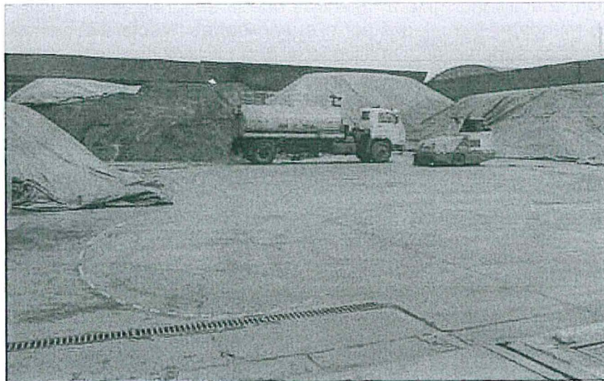
Fotografía N° 24. Zona de fisuras y grietas en la losa del patio N° 3, cerca de la zona de lavado de los camiones. Observación N° 6 del año 2011.
