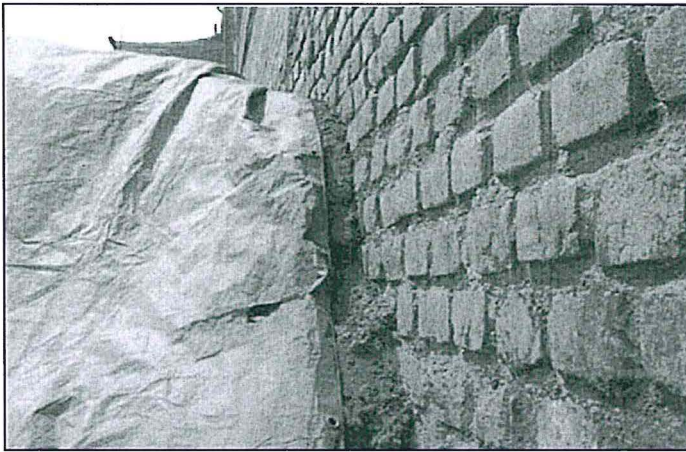
Foto N° 07 del Informe Supervisión 2011: Observación 04 y Recomendación 03-2010, obsérvese las rumas de concentrado se encuentran pegadas al cerco perimetral, utilizándose como un muro de contención en el patio N° 1
