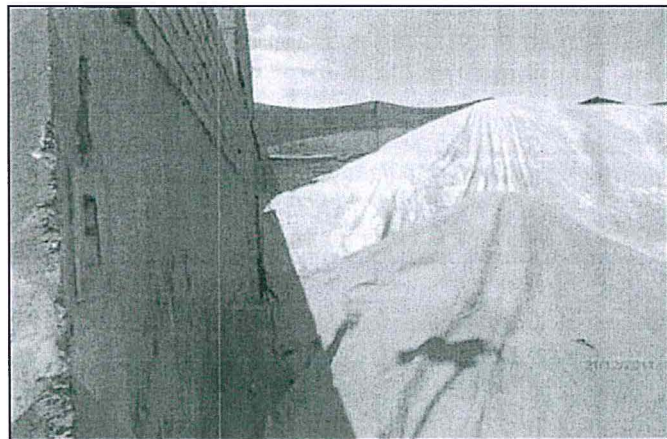
Foto N° 08 del Informe Supervisión 2011: Observación 04 y Recomendación 03-2010, obsérvese las rumas de concentrado, se encuentran pegadas al cerco perimetral, utilizándose como un muro de contención, en el patio N° 2.
