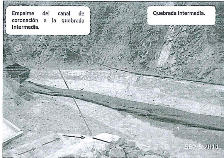
Fotografía N° 5: Otra vista de empalme del canal de coronación hacia el canal de captación ubicado a lo largo de la quebrada Intermedia. Recomendación N° 3 – Supervisión Especial (Diciembre) 2011.
