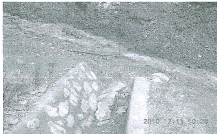
Fotografía N° 42: Canal de coronación inconcluso hacia el lado norte, no se encuentra empalmado con el canal lateral.
