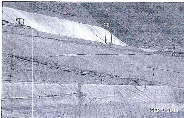
Fotografía N° 12: Poza de eventos, la cual consta de su sistema de detección de fugas. Recomendación N° 6 – Supervisión Especial (Diciembre) 2010.
