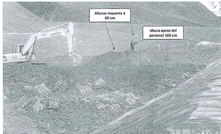
Fotografía N° 13: No se realiza la compactación del material del relave en capas de 30 cm.
