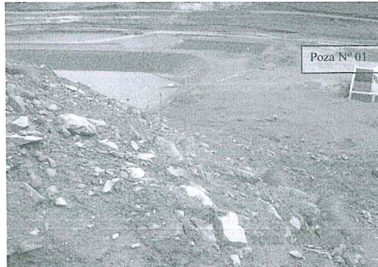
Fotografía 45: Existencia de una sola poza de recolección con el sistema de detección de fugas inoperativo.
