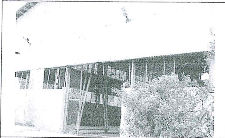
Vista Fotográfica N° 5: Vista panorámica que muestra el ingreso a la casa de máquinas, se evidencia la inexistencia de transformadores.
