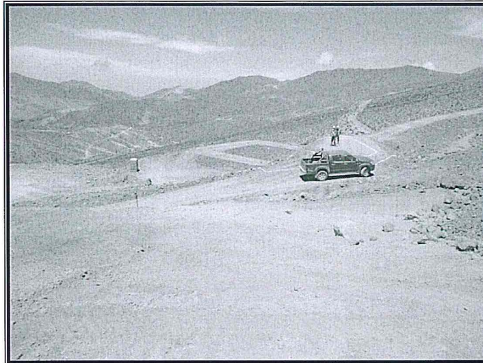
Fotografía N° 31: Base del depósito de desmontes de la unidad minera y poza de colección del sistema de sub-drenaje en construcción; no se observa capa impermeabilizante a base de caliza de 3,000 mm. de espesor.
