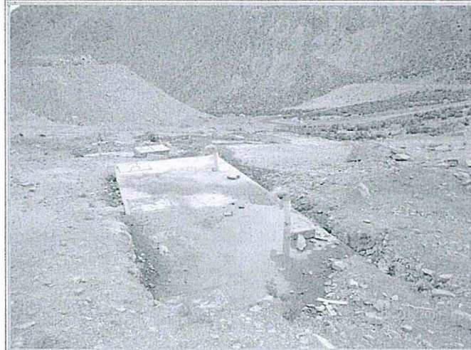
Fotografía N° 20: Pozo séptico colapsado de campamentos de las Contratistas JJC, Cam Perú, entre otras, colindante a Campamento Timpure, las aguas provenientes por el sistema de alcantarillado enterrado evacuan aguas servidas directamente al ambiente.
