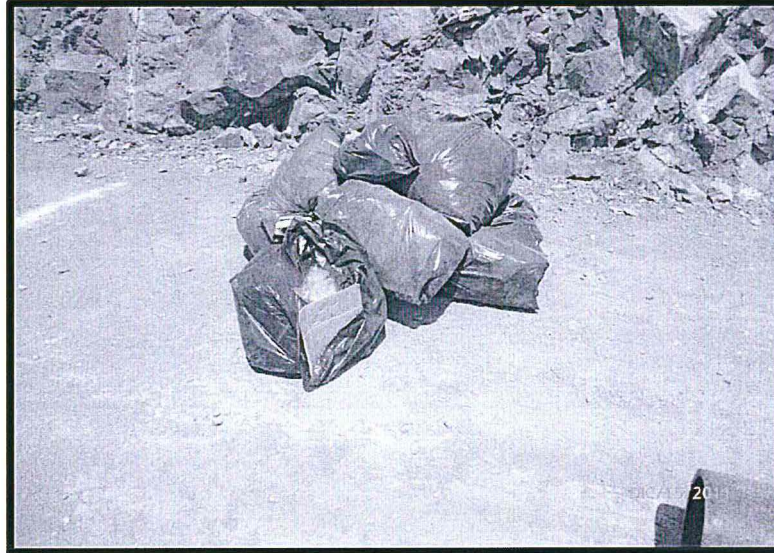
Fotografía N° 2: Inadecuada disposición de los residuos sólidos industriales peligrosos y no peligrosos en el área industrial en construcción, los residuos sólidos se ubican fuera de los contenedores y en recipientes inadecuados (bolsas plásticas).
