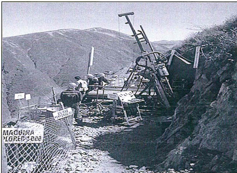
Fotografía N° 3 del Informe de Supervisión.- Plataforma de perforación N° 1 y máquina de perforación diamantina.
