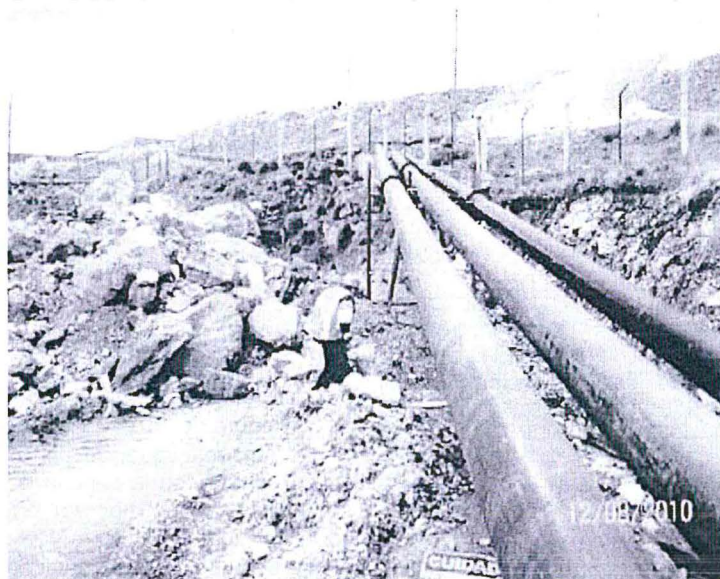
Fotografía N°2.56: Al pie del talud del terreno colindante con la cancha de mineral de la Planta Concentradora no se encontró al canal de derivación
