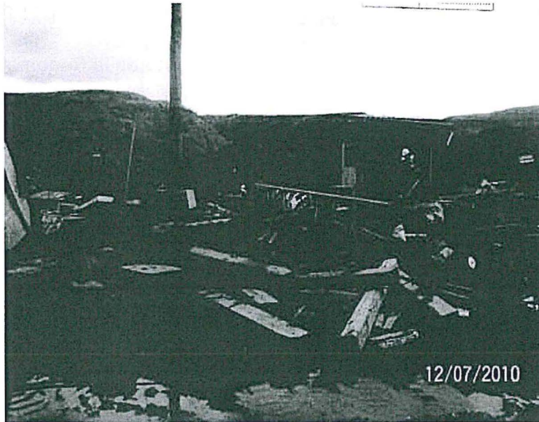
Fotografía N° 2.37: Materiales sin clasificar y sin identificar en el área de almacenamiento de materiales reutilizables de la contrata Consorcio Pasco.
