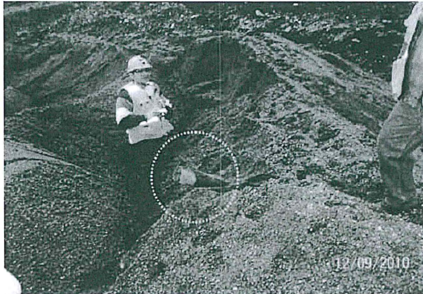
Fotografía N° 2.74: Se aprecia que el piezómetro P1-08 ha sido tapado con material de construcción granulado y que no existe el cartel informativo.
