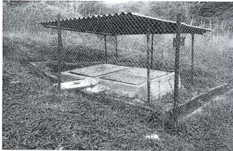
Foto N°07-Pozo de lixiviados encapsulando tuberías de lixiviados
