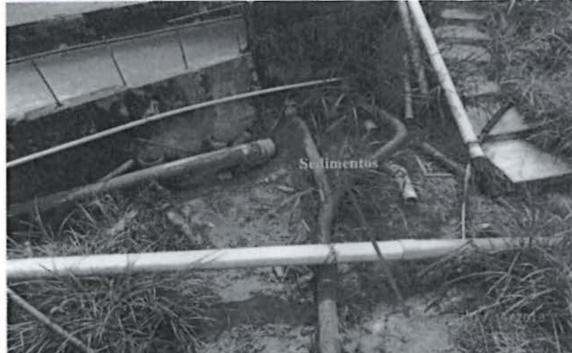
Fotografía N° 90 del Informe de Supervisión.- Durante la supervisión, se observó en la parte baja del Sedimentador N° 1, la presencia de partículas sólidas dispuestas sobre suelo orgánico aledaño y flora.
