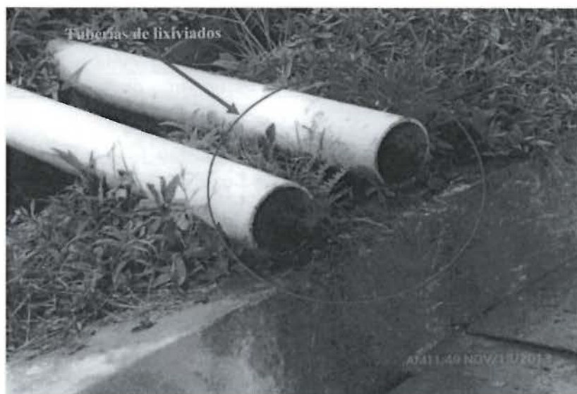
Fotografía N° 116 del Informe de Supervisión: Durante la Supervisión, se observó que los lixiviados están cayendo sobre el dique y la flora aledaña natural, situada en la poza de lixiviados del relleno sanitario.
