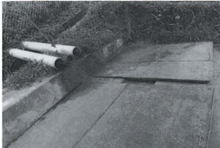
Fotografía N° 115 del Informe de Supervisión: Durante la supervisión, se observó que las tuberías de descarga de los lixiviados provenientes del relleno sanitario son cortas, permitiendo que dichos líquidos caigan en el dique y la tapa metálica de la poza de lixiviados.
