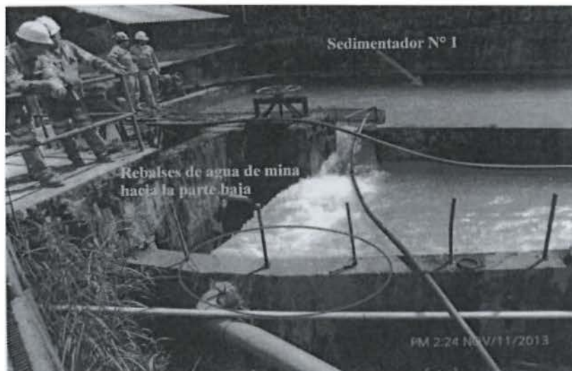
Fotografía N° 88 del Informe de Supervisión.- Durante la supervisión, se observó que el Sedimentador N° 1, donde se tratan las aguas de mina que salen mediante un canal por la bocamina Nivel 4755, presenta rebalses de dichas aguas hacia la zona aledaña.
