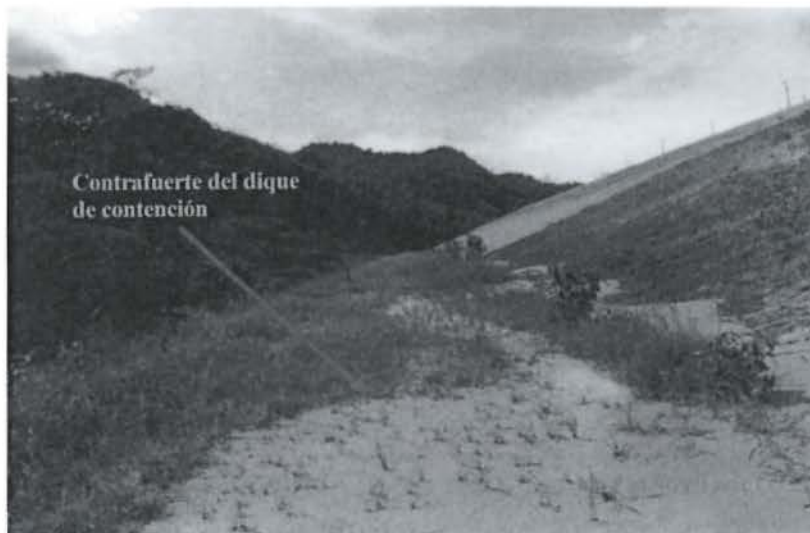
Fotografía N° 100 del Informe de Supervisión. - Durante la supervisión se observó material fino dispuesto sobre el contrafuerte del dique de contención, proveniente de las erosiones de la parte superior del talud.
