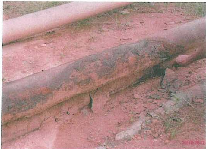
Foto 26: Vista más cercana de la tubería en mal estado y se observa que la tubería operativa también tienen signos de encontrarse en mal estado.
