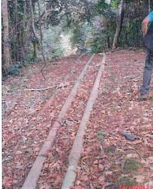
Foto 22: Otra vista de la tubería tendida sobre el suelo sin ninguna protección contra la integridad de la tubería.
