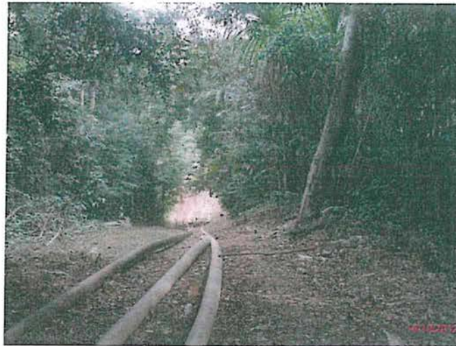
Foto 21: Líneas de flujo de los pozos que se encuentran tendidos sobre la superficie del terreno y sin ninguna protección contra la corrosión
