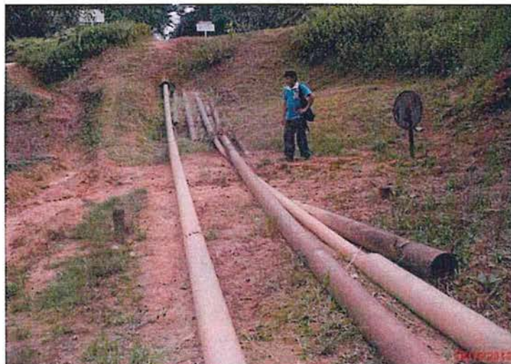
Foto 24: Vista de las líneas de flujo de los pozos y otras tuberías que han sido abandonadas luego de los cambios efectuados a los tramos en mal estado.
