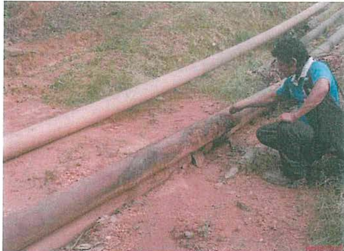
Foto 25: Monitor de la FEDIQUEP ingresando un pequeño trozo de madera en un tramo en mal estado, cambiado y abandonado en el sitio, debajo de esta tubería una línea que se encuentra operativa.
