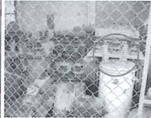
Vista 2. Transformadores fuera de uso que no cuentan con información de contenido de PCB.
