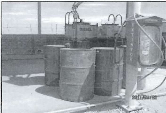
Fotografía N° 04: Vista panorámica del área de almacenamiento de combustibles líquidos y lubricantes de la Bateria Providencia, se evidenció que no cuenta con un adecuado sistema de contención secundario que permita contener posibles derrames.
