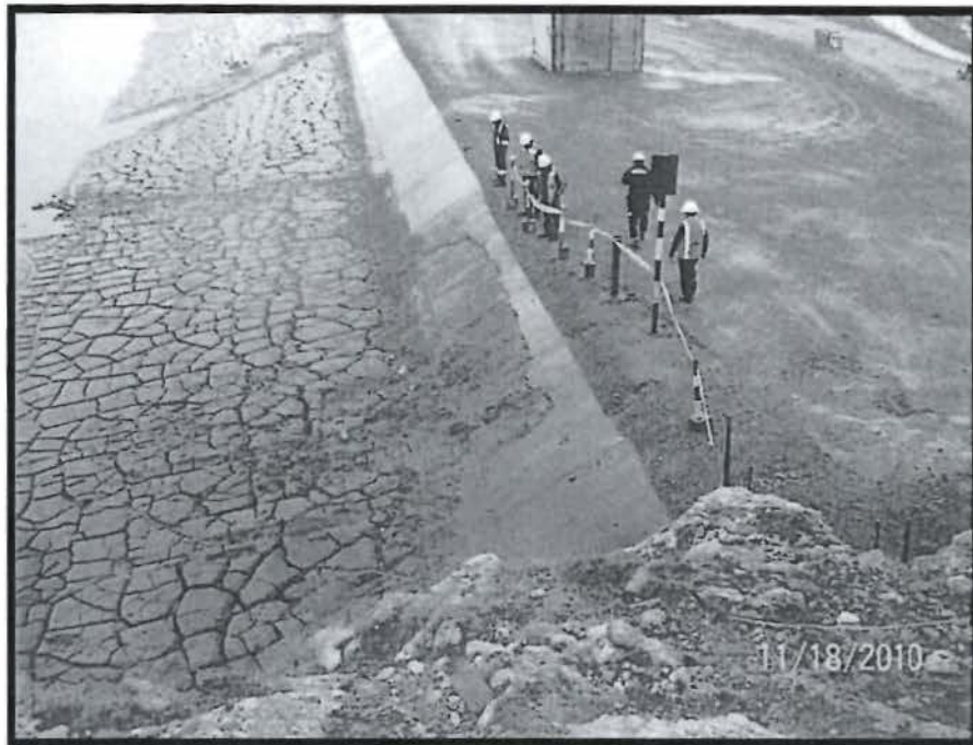
Fotografía N°2.25: Tramo del espaldón aguas arriba del sector derecho del depósito de relaves Ocroyoc con escoriaciones que no han sido refacciones.
