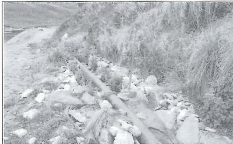
FOTO N° 9: Tramo de canal de coronación del Tajo de la mina que se encuentra obstaculizado por rocas desprendidas y otros (tubería de agua), y además por falta de mantenimiento.
