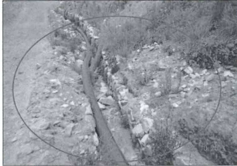
Fotografía N°13: Canal de coronación del tajo Cerro Corona, construido con piedra, de sección trapezoidal, con una tubería HDPE de conducción de agua en su interior, no cumpliendo con el objetivo para el que fue construido, Recomendación N° 5, UM Cerro Corona, 2011.
