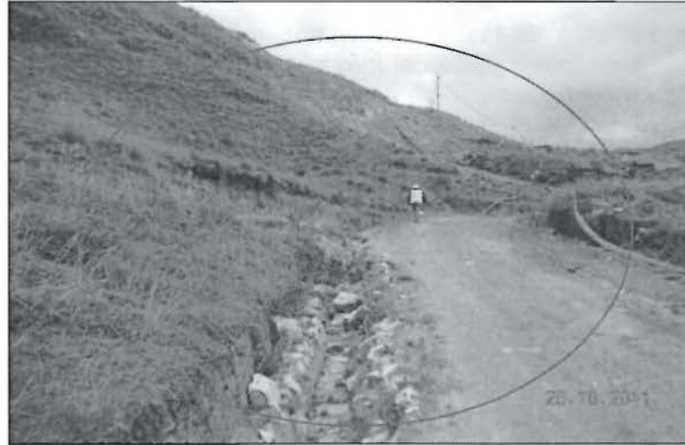
Fotografía N° 11: Canal de coronación del tajo Cerro Corona, construido con piedra, de sección trapezoidal y obstruido con piedras y tierra no cumpliendo con el objetivo para el que fue construido, Recomendación N° 5, Recomendación N° 5 – 2010, UM Cerro Corona, 2011.
