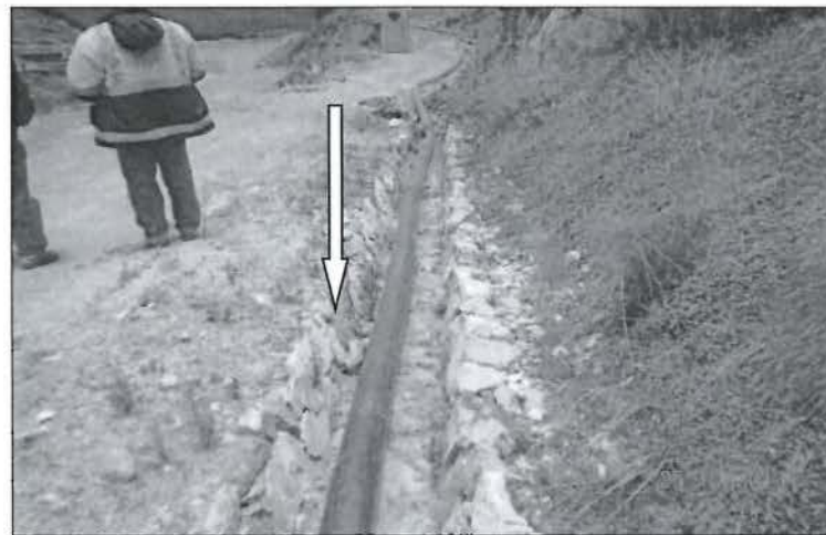
Fotografía N° 12: Canal de coronación del tajo Cerro Corona, construido con piedra, de sección trapezoidal, con una tubería HDPE de conducción de agua en su interior, no cumpliendo con el objetivo para el que fue construido, Recomendación N° 5, UM Cerro Corona, 2011.
