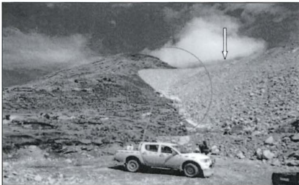
Fotografía N° 36: Depósito de desmote Este, no se observa estructuras hidráulicas como canales de coronación.
