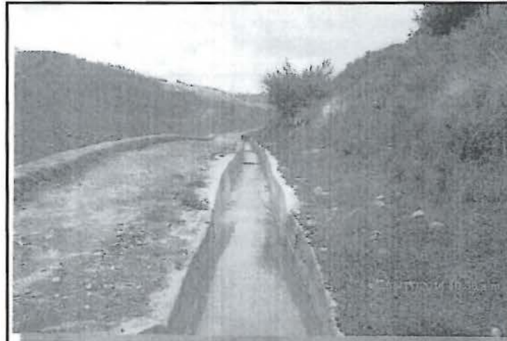
Foto 72: Recomendación N° 9, canal San Nicolás se encuentra impermeabilizado para evitar las infiltraciones hacia el suelo, ubicado aguas abajo de las relaveras.
