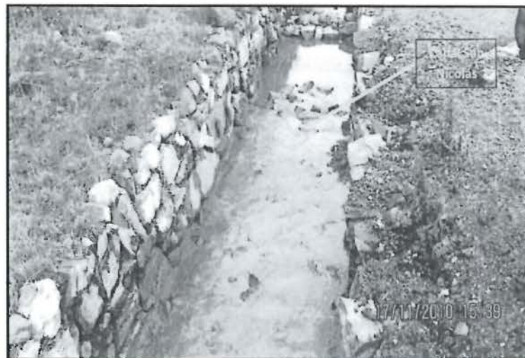
Fotografía N° 9: Canal Minera San Nicolás con enrocado del piso y laterales, que colecta las aguas de infiltración de pasivos ambientales de relaveras.
