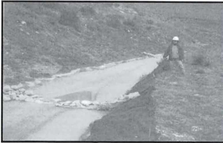
Fotografía N° 12 del Informe de Supervisión.- Durante la Supervisión, se observó que un tramo del canal de coronación de la Presa de Relaves que se encuentra impermeabilizado se encuentra colmatado de sedimentos.
