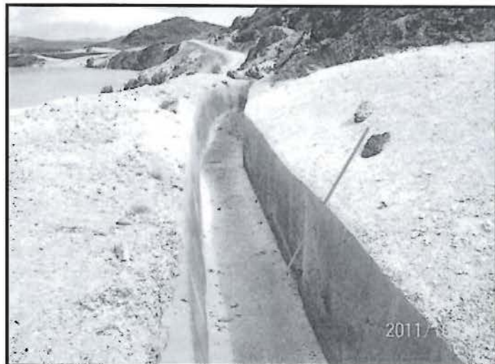
Foto N° 43: Otra vista del canal de coronación del depósito de relaves, donde se observó que está operativo y con buen mantenimiento.
