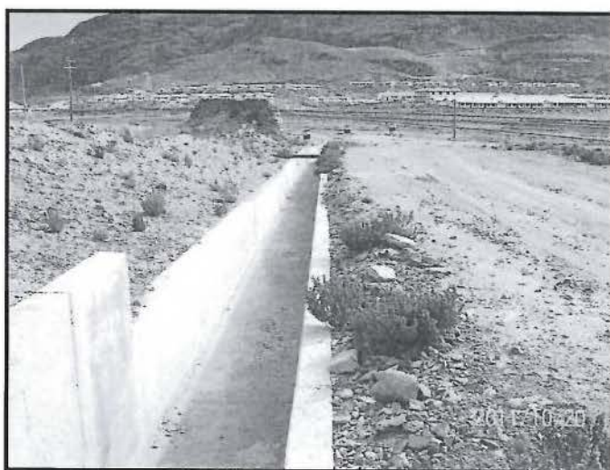
Foto N° 57: Otra vista del canal de coronación por donde circula las aguas superficiales de escorrentía y agua del subdrenaje para ser derivados al río Arocampa.
