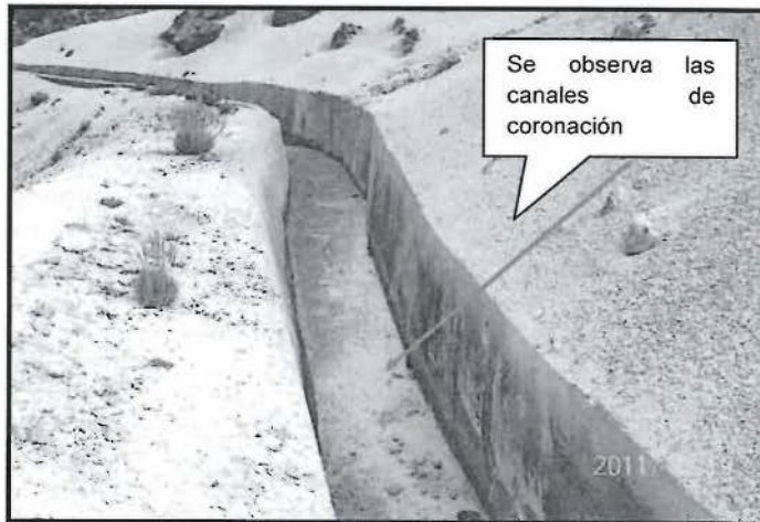
Foto N° 42: Canal de coronación de concreto armado de 0,80 m de ancho x 1, 20m de altura aproximadamente del depósito de relaves, donde se observó que está operativo y con buen mantenimiento.
