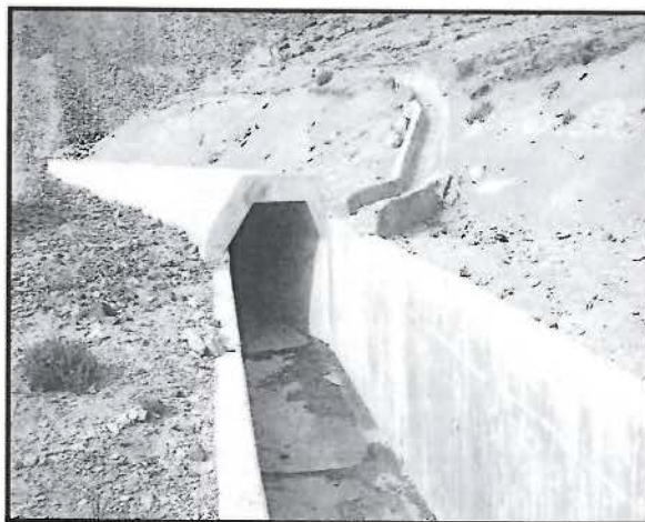
Foto N° 56: Canal de coronación por donde circula las aguas superficiales de escorrentía luego de haber pasado por el desarenador donde ha sido sedimentado y es punto de unión con las aguas eventuales del subdrenaje del depósito de desmonte Mariana para luego ser derivados al río Arocampa.
