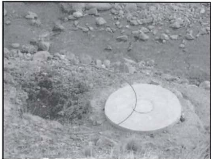
Fotografía 120: Poza de percolación del sistema de pozo séptico de las oficinas administrativas, cuyos efluentes van al río Arocampa, U.P. Arcata. Recomendación N° 13
