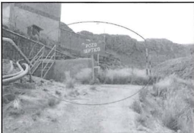
Fotografía 115: Pozo séptico de planta concentradora, punto de vertimiento no oficial, la unidad minera no ha declarado este punto de vertimiento de efluentes domésticos U.P. Arcata. Recomendación N° 13
