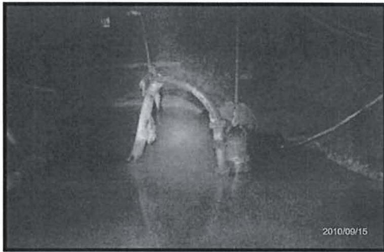
Fotografía N° 5: Mina – Vista de futura Sala de Bombas Recomendación N° 2 de la Supervisión Ambiental 2009, levantada en 60%. Se recomienda entubar y bombear independientemente las aguas limpias a la superficie.
