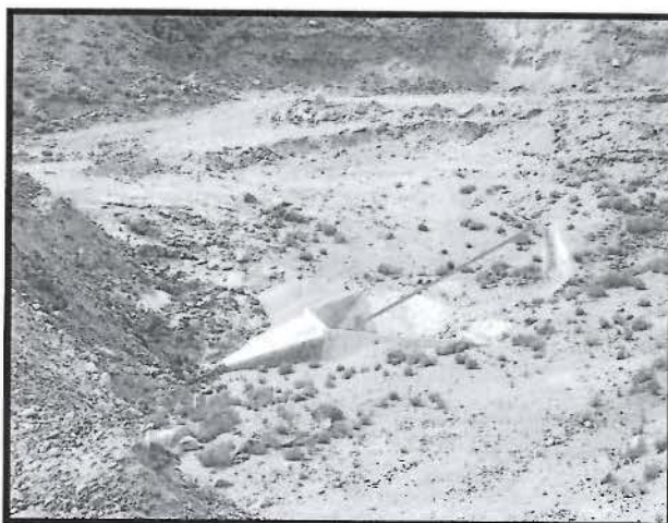
Foto N° 55: Vista del desarenador que recibe las aguas superficiales del canal de coronación del depósito de desmonte Mariana.
