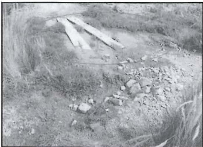
Fotografía 117: Descarga de efluente del pozo séptico de la planta concentradora hacia el cauce del río Arcopampa, U.P. Arcata, viene fotografía N° 116. Recomendación N° 13.
