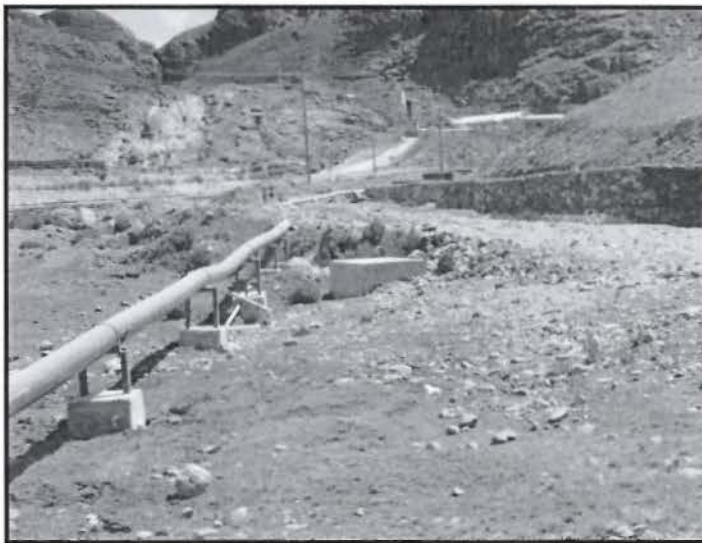
Fotografía N° 3: Detalle de la tubería que proviene de la desmontera Mariana y se dirige a la poza de colección del subdrenaje.
