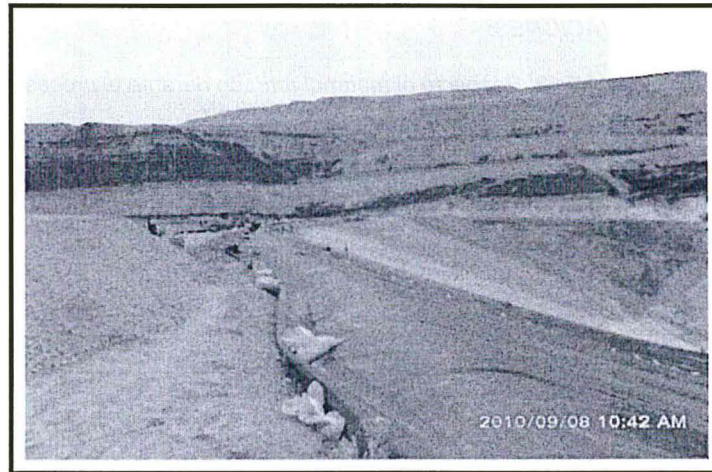
Fotografía N° 39 del Informe de Supervisión: Actividades de construcción de la ampliación del PAD 20 sobre la Desmontera N° 8.
