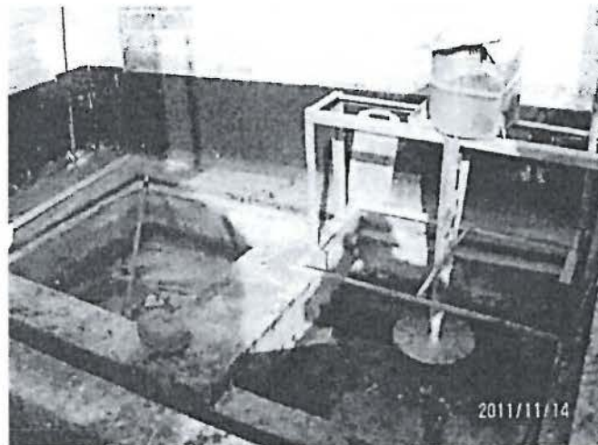
Fotografía 2: Poza de decantación y de tratamiento de grasas sin uso
