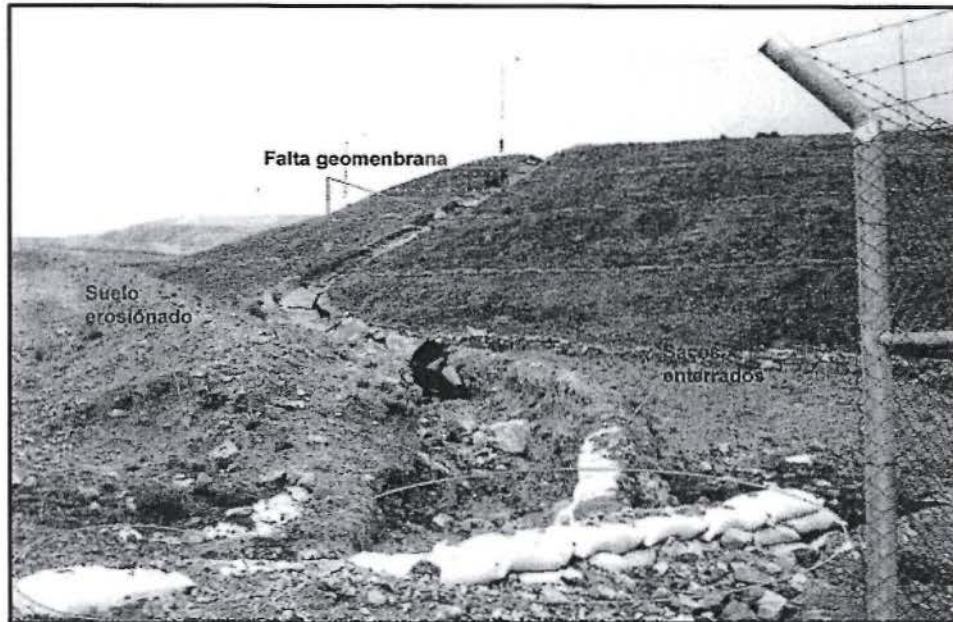
Fotografía N° 6.- Observación 2, supervisión 2011: Se observó que en el canal de drenaje de agua superficial de la poza SUMP N° 5 Etapa 10 – Pad Carachugo, algunas partes se encuentran sin geomembrana, así mismo se puede apreciar que dicho canal e encuentra erosionada en la parte baja de su recorrido.
