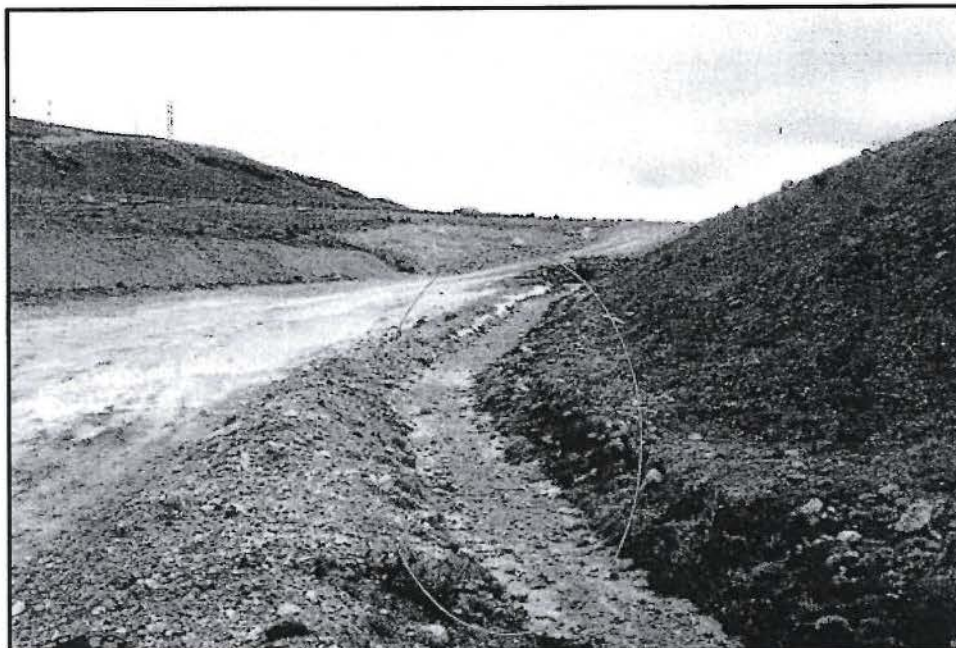
Fotografía N° 8.- Observación 2, supervisión 2011: Podemos apreciar que dicho canal se encuentra erosionada en la parte baja de su recorrido, donde falta realizar la conformación de dicho canal de manera adecuada.
