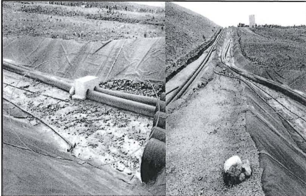
Fotografía N° 14.- Observación 4, supervisión 2011: Se observa que los canales impermeabilizados con geomembrana, que conducen las tuberías de HDPE que llevan solución rica al Pad de lixiviación 6, ubicado en el Pad de lixiviación de Yanacocha Norte, se encuentran sedimentos.
