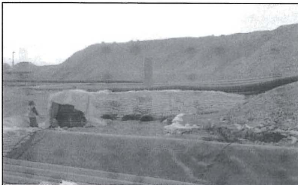
Fotografía N° 152. Cumplimiento de recomendación N° 3-2011: Vista en un primer plano de los sacos en buen estado que soportan las tuberías que conducen agua.
