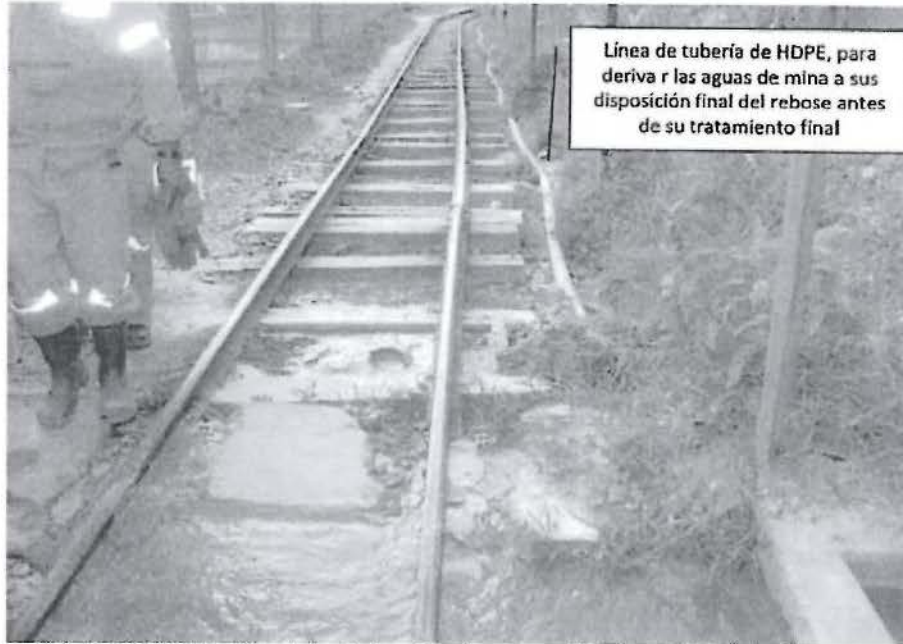
Fotografía N° 19.- Canal de derivación de aguas de mina de la bocamina Estrella (Nv – 1467), en el cruce de la vía férrea hacia las pozas de sedimentación se produce un rebose de las aguas al ambiente antes de su tratamiento final de sedimentación.
