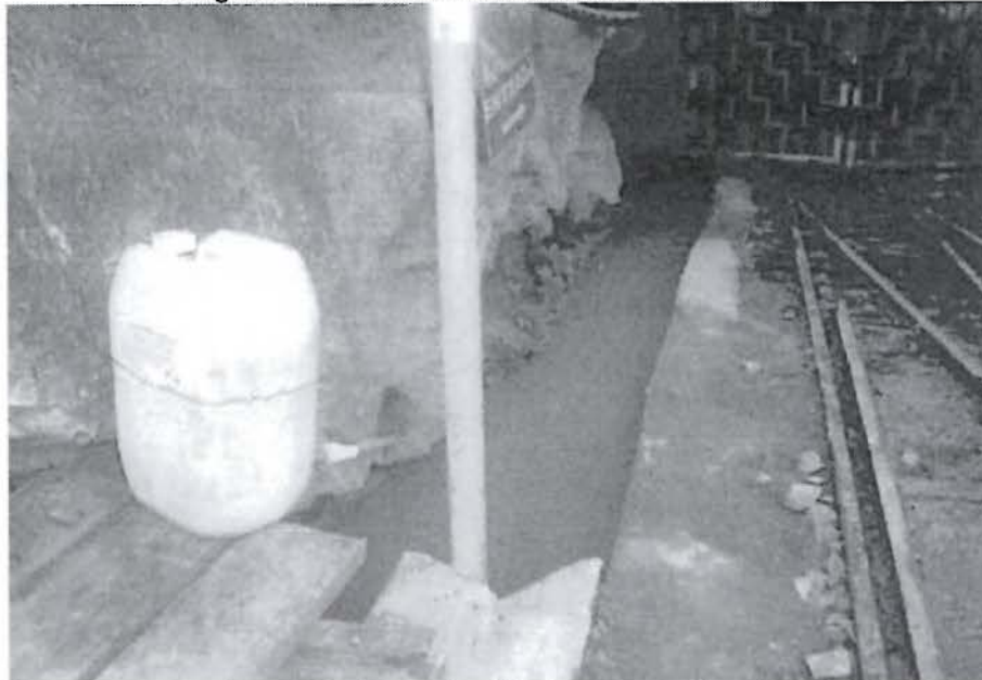
Fotografía N° 18.- Canal de derivación de las aguas de mina a través de la bocamina Estrella, Nv-14-67 hacia las pozas de sedimentación
