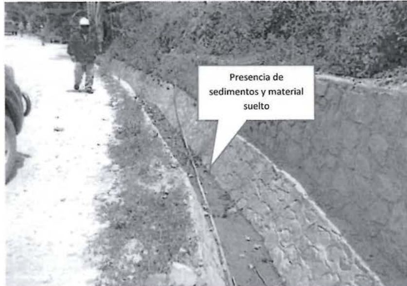
Fotografía N° 91.- Estructura hidráulica (canal de coronación) superior del depósito de desmontes Santa María presenta sedimentos (lodos) y material suelto sobre su cauce.
