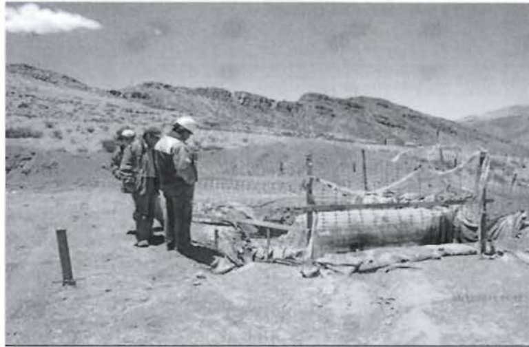
Foto 05: Observación 02, poza de lodos del área de exploración Canahuire (quebrada Agani), sin haberse concluido con los trabajos de cierre progresivo, expuesta a inundación por las aguas de escorrentía. Con material dispuesto a un costado, formando una berma.
