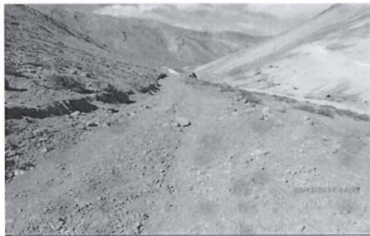
Foto 23: Recomendación 03-2010, acceso principal al área de exploración Katrina, sin cunetas construidas.
