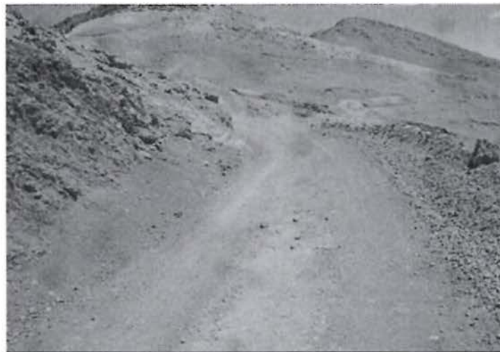
Foto 04: Observación 01, accesos a las plataformas del área de exploración Canahuire (quebrada Corire), sin cunetas para la derivación de las aguas de escorrentía.
