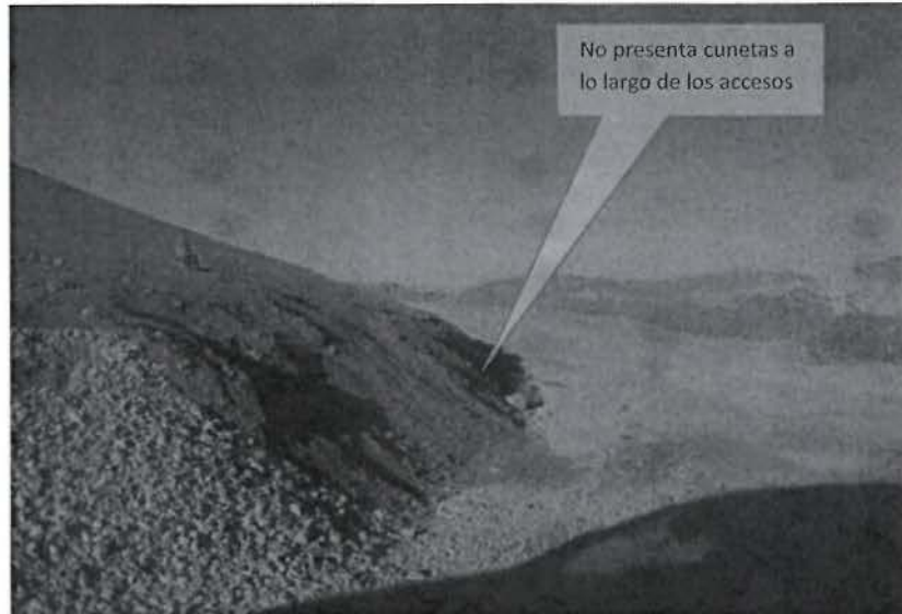
Fotografía N° 28 . Se observa que las vías de acceso a las áreas de plataformas de exploración en el área de Katrina no cuentan con cunetas proyectadas para este componente – accesos.
