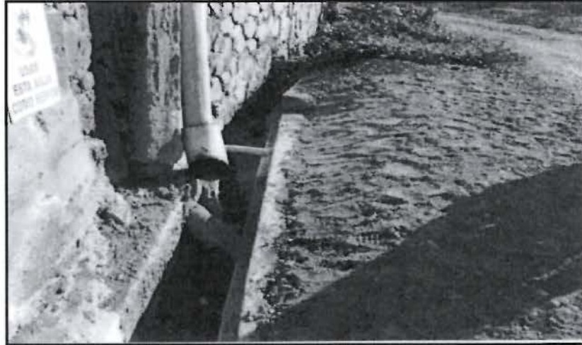
Fotografía N° 10 del escrito de descargos de Poderosa: La foto muestra el tubo soldado, las aguas cianuradas descargan directamente al sistema de drenaje
