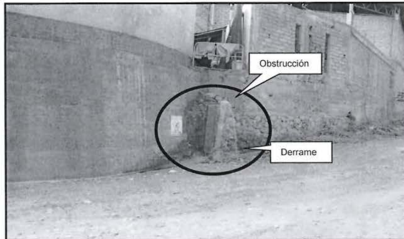
Fotografía N° 71: Vista del ducto obstruido que ocasiona el derrame de agua cianurada.
