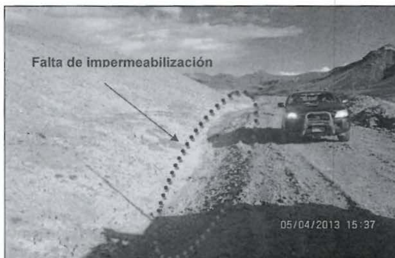
FOTOGRAFIA N° 06.- Vista fotográfica del canal de colección de drenaje del Botadero 1, no tiene impermeabilización.
