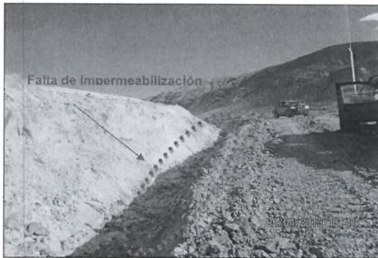
FOTOGRAFÍA N° 7.- El canal de colección de drenaje del Botadero 1, no tiene impermeabilización.
