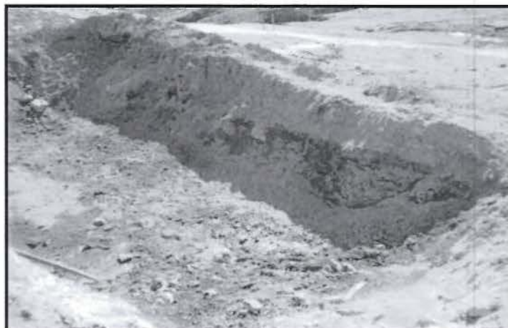
Fotografía N° 16 del Informe de Supervisión: Se observa la Poza N° 01 sin agua. El agua fue evacuado por cisternas a la planta de tratamiento de agua de mina. Se observa que esta poza no contaba con impermeabilización.
