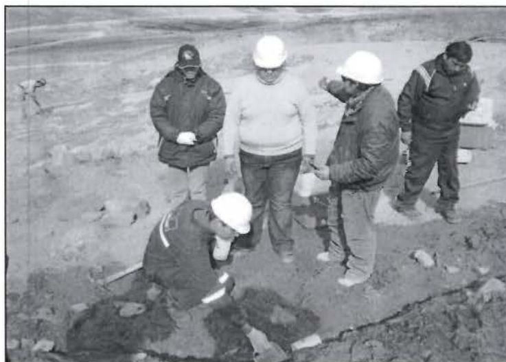
Fotografía N° 5 del Informe de Supervisión: Monitoreo de las filtraciones presentes en el área de la Poza N° 01.
