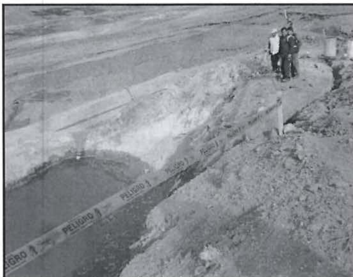
Fotografía N° 3 del Informe de Supervisión: Se observa la Poza N° 01, la misma que no cuenta con ningún sistema de recubrimiento.
