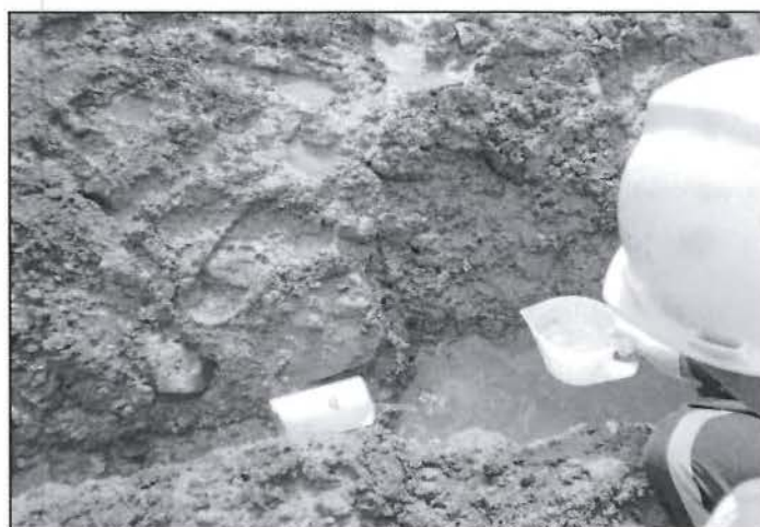
Fotografía N° 6 del Informe de Supervisión: Monitoreo de las filtraciones presentes en el área de la Poza N° 01. Para el monitoreo se habilitó una sección para poder tomar la muestra respectiva.
